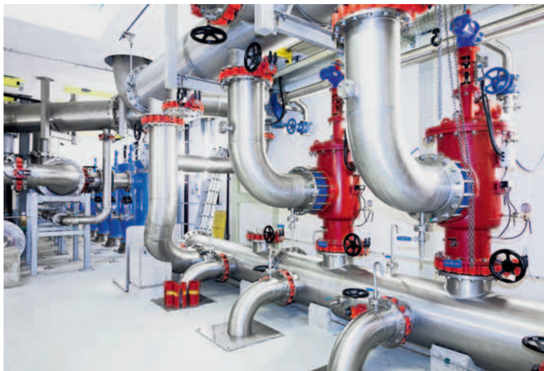
Un réseau de 30 kilomètres de tuyaux constitue GeniLac.
